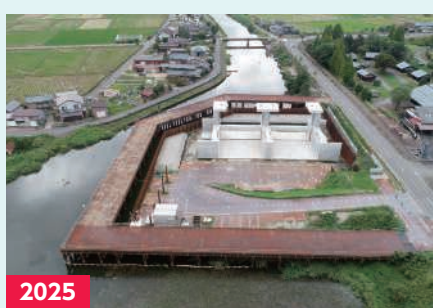
2025 福島漏水門本体（新潟県）
