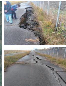
能登空港被災状況
