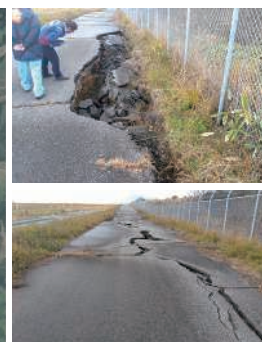
能登空港被災状況
