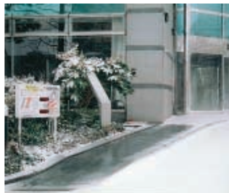
興和本社屋前のスロープに設けられた「ヒートパイプ融雪施設」の融雪状況です。本施設は、地中熱をヒートパイプにより地表面へ運び、融雪を行います。電気や燃料を使用しないので環境にやさしく、さらに出力の調整や点検等のメンテナンスは必要ありません。
